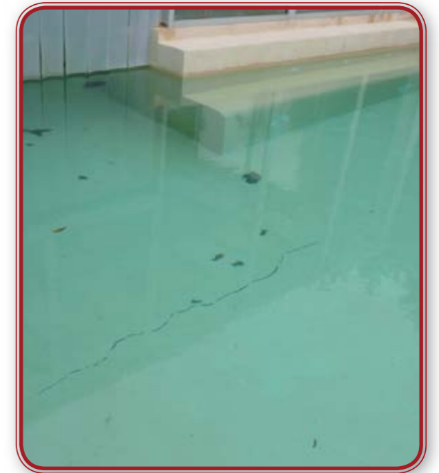
Tassement différentiel dans une piscine
