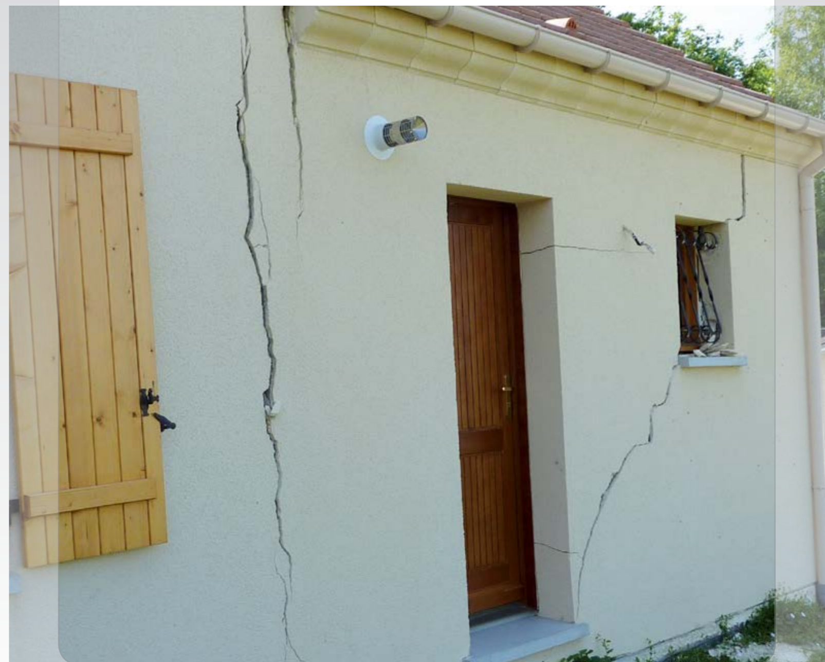
Lézardes sur la structure d'un pavillon
