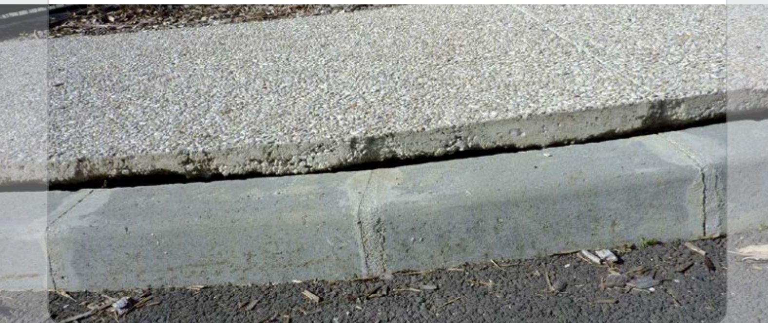
Soulèvement d'un dallage dû à la présence de sulfate
