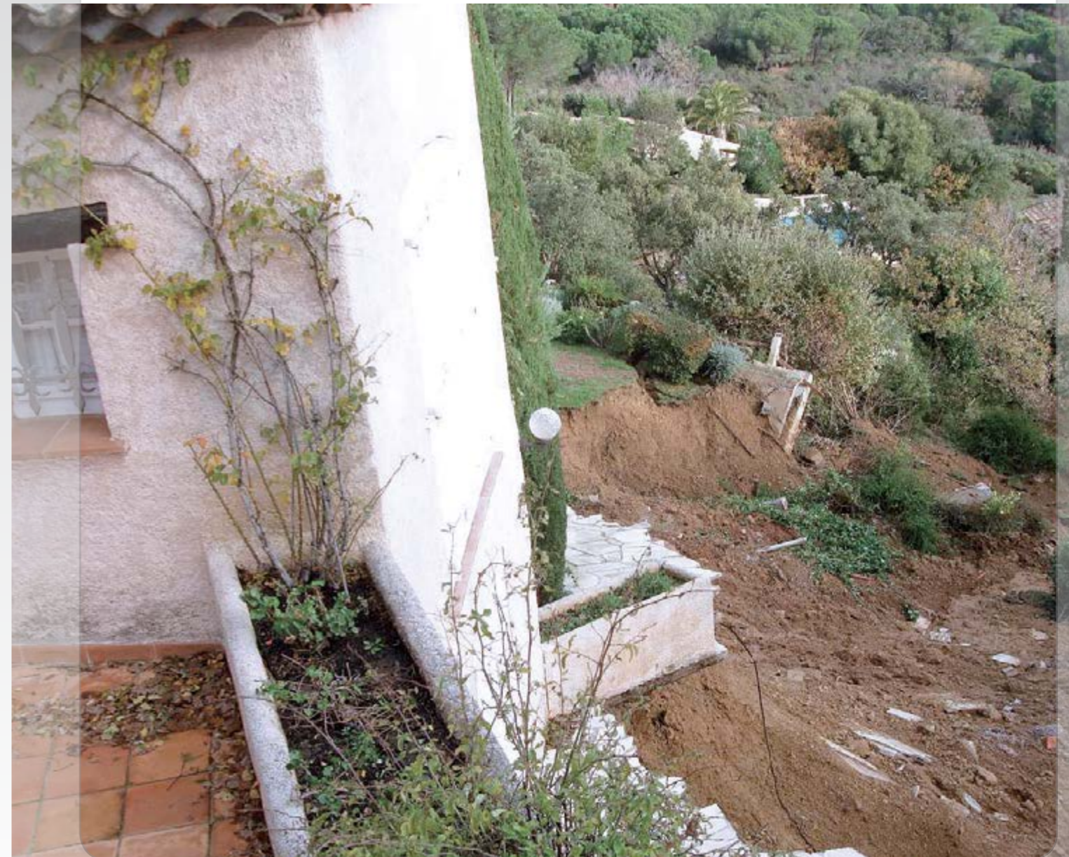
Glissement de terrain à Ramatuelle
