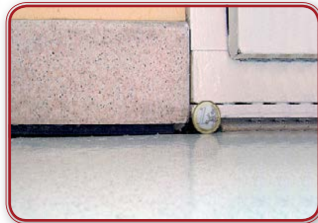
Tassement de dallage dans une maison
