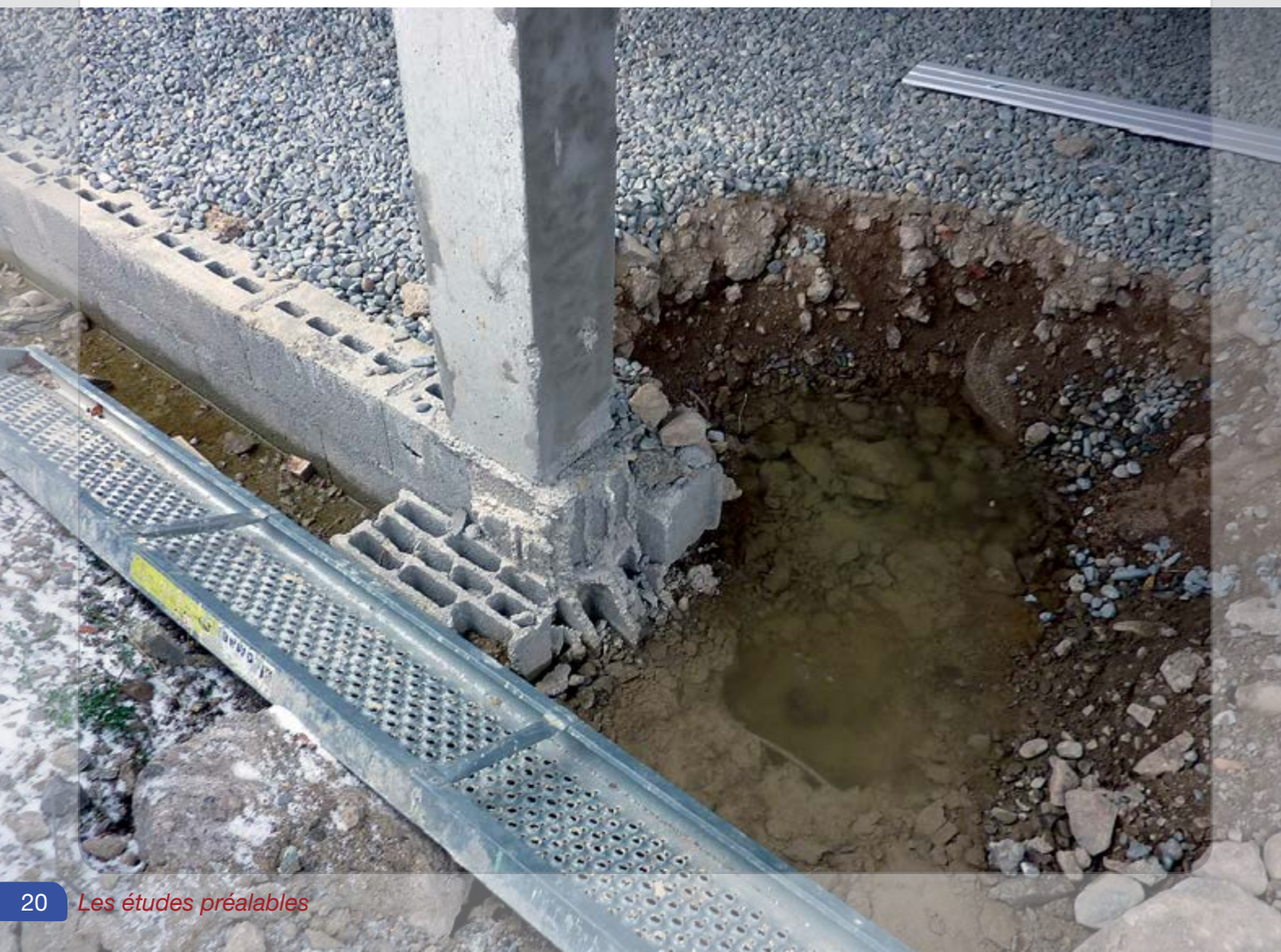
Mauvaise exécution d'une jonction poteau/fondation
