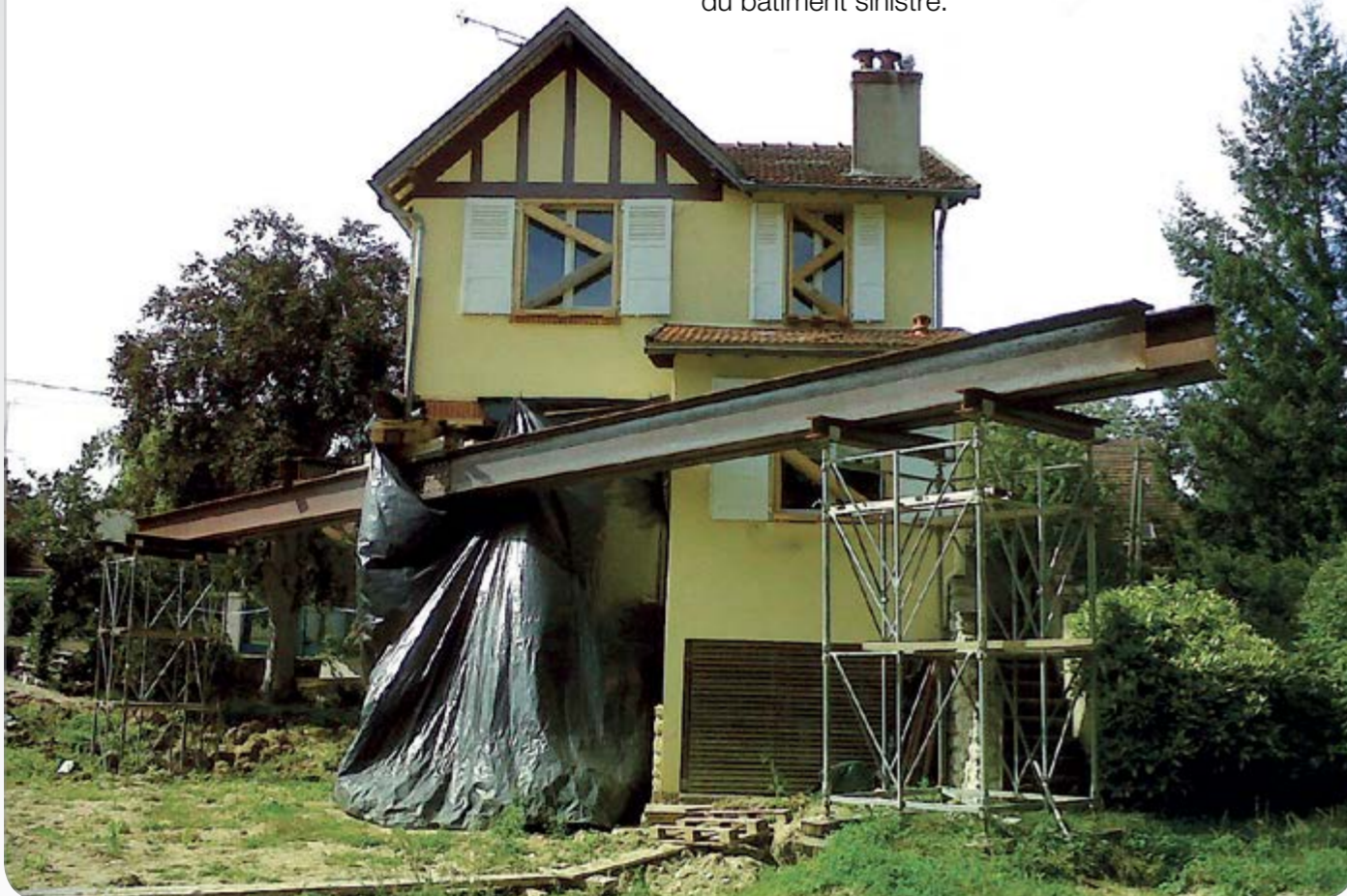
Effondrement d'une partie de la maison suite à un décaissement du sol à proximité
