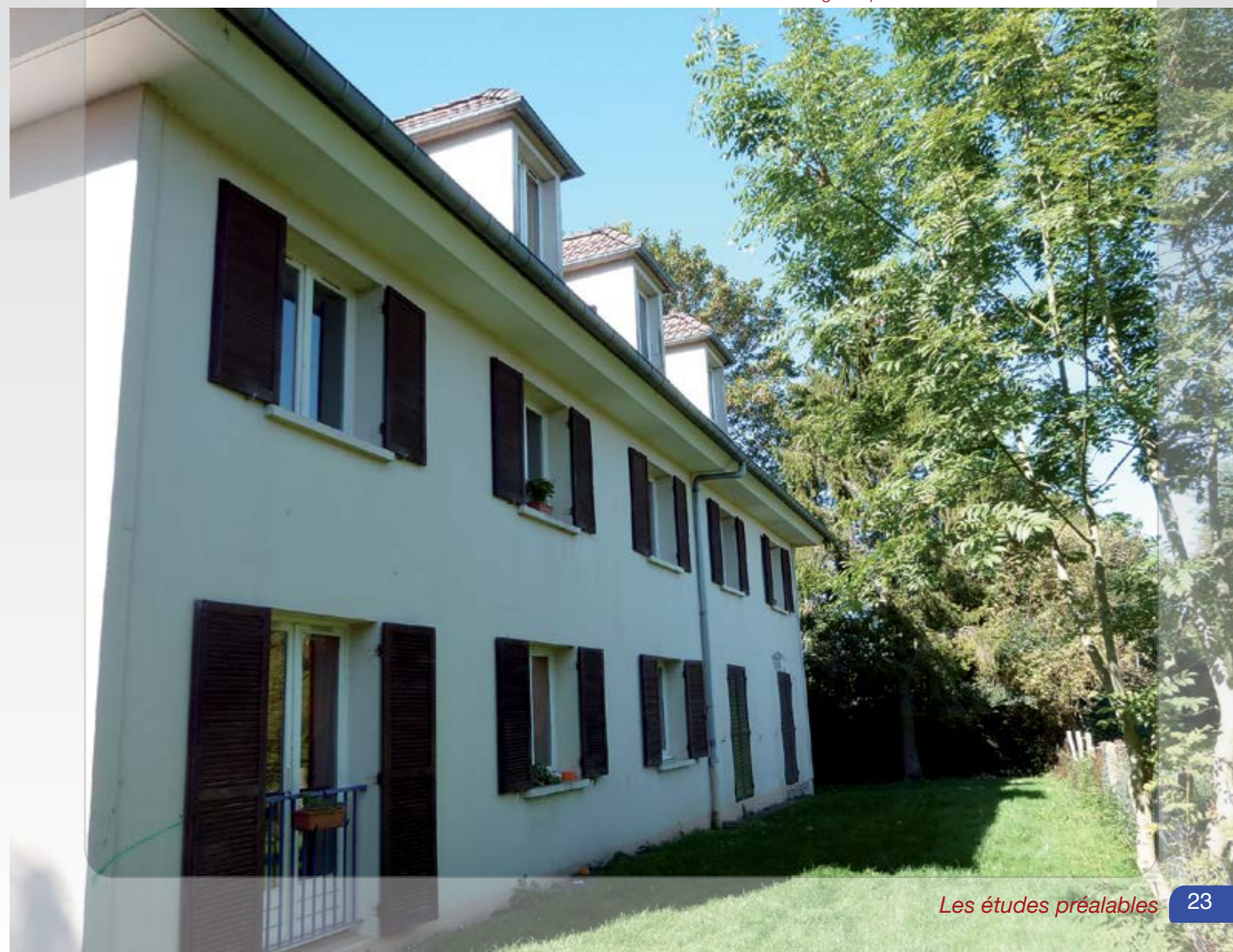
Absence de trottoir périmétrique et présence d'arbres à hautes tiges à proximité d'un bâtiment sinistré
